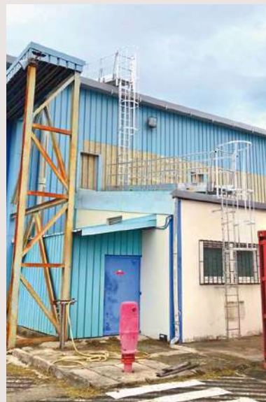
Échelles à crinoline et passerelles sur toitures
