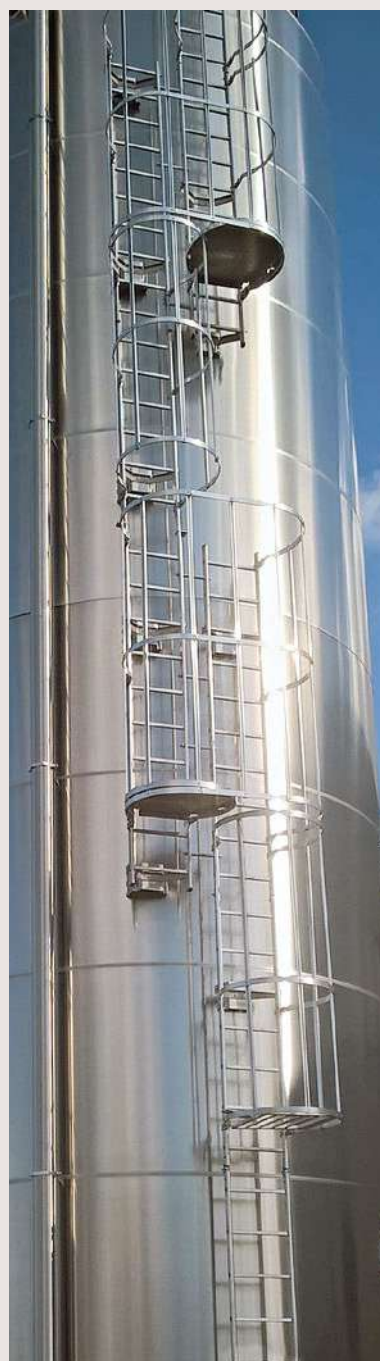
Échelle à crinoline sur cuve de stockage
